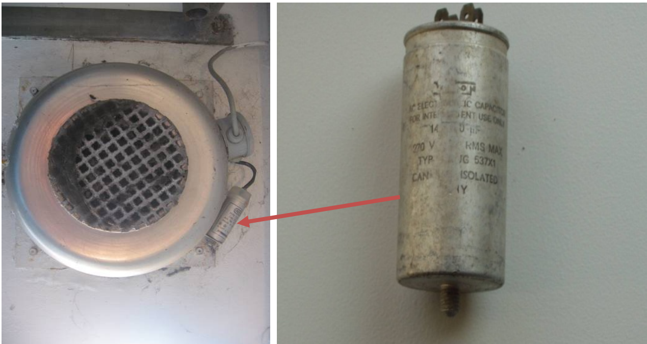
Foto: Eksempel på kondensator i forbindelse med motor til ventilator.
